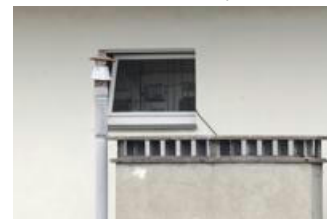
Le câble d'alimentation atteignant la prise
