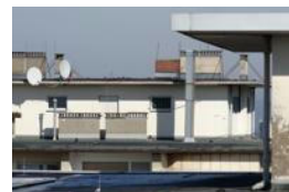
Le câble d'alimentation sur le toit
